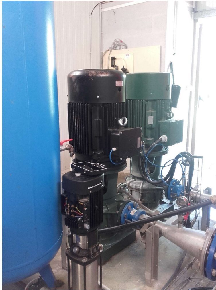
Figure 7 : Pompes de refoulement
