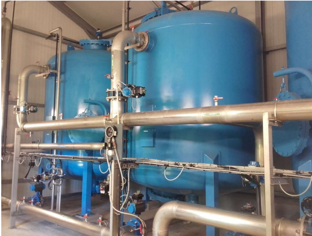
Figure 4 : Filtre à sable
